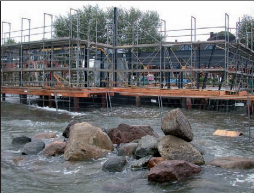
„Land unter“ auf der Baustelle am 28. September 2007
